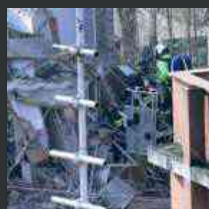
Fuga di gas, esplosa una casa in via Baiamonti: un morto
